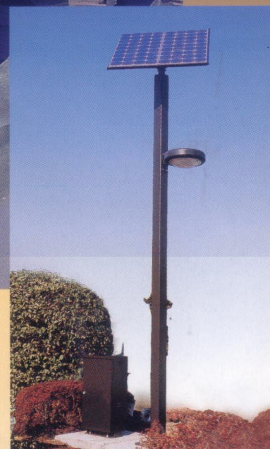
区役所前広場の外灯
