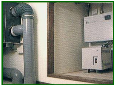
屋根裏部屋の インバーター
